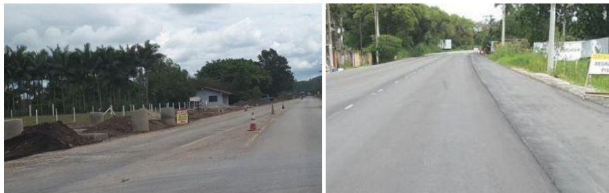
Figura 10. Obras de ampliação da Rodovia Jorge Lacerda (Secretaria de Estado de Infraestrutura/2018).
