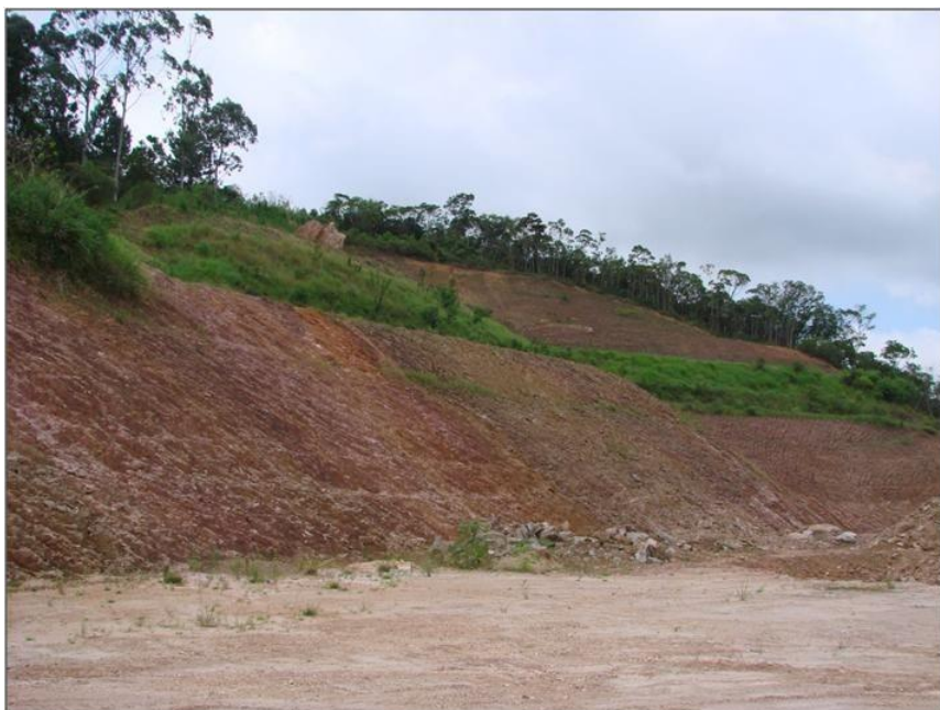
Figura 120. Frente de lavra desativada, na face leste da encosta.
