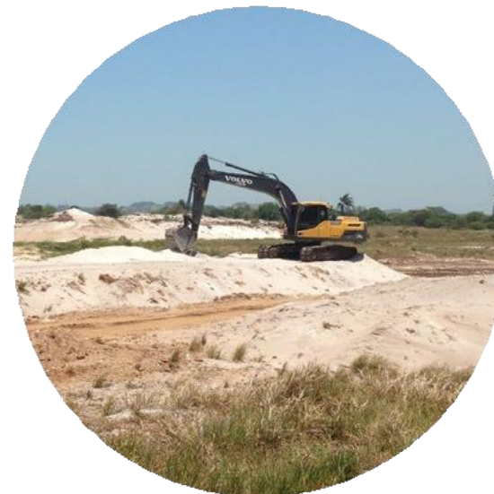
Preparação da área de lavra com a remoção do solo orgânico e estéril por escavadeira hidráulica e abertura de acessos para o início da lavra por escavadeira hidráulica.
