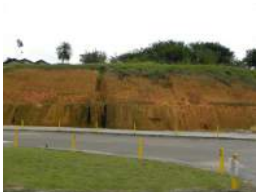
Foto 10.1-53: Caracterização de erosão linear rasa, evoluindo para profunda em talude de corte sobre rocha saprolítica, associada ao padrão de relevo definido por uma colina, local com interferência antrópica sem controle de drenagem. Registro na região do Ribeirão Fortuna, município de Timbó/SC. Coord.: 22 J 674842 m E 7035760 m S.
