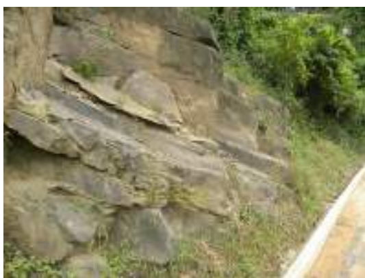
Foto 10.1-55: Detalhe de talude de corte, onde o acamamento rochoso, aliado a fraturas da rocha e associados a uma direção do talude não favorável à estabilização da rocha favorecem o escorregamento planar, envolvendo partes do maciço rochoso. Registro em talude na BR 470, próximo à confluência entre os rios Itajaí-Açu e Itajaí do Norte, Ibirama/SC. Coord.: 22 J 649151 m E 7004106 m S.
