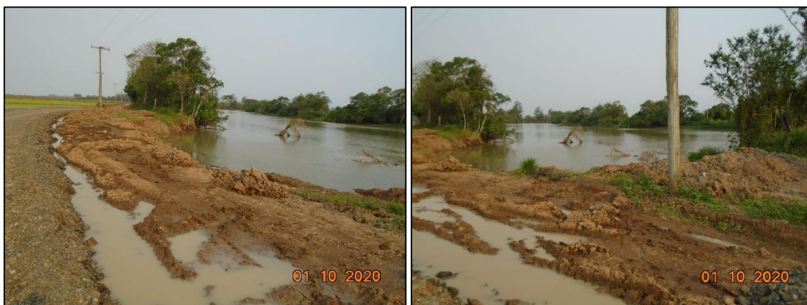
Figuras 26 e 27: Vista da Área de Preservação Permanente do Rio Araranguá com a presença de erosão as margens do rio Araranguá.
