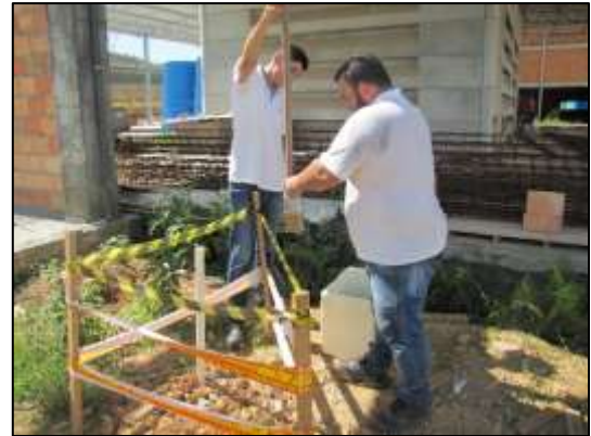
Figura 61: Coletas de água subterrânea no Ponto 03, entre a ETE e oficina.
