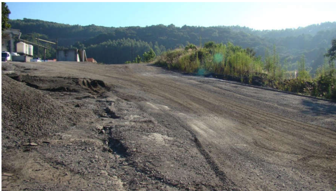
FIGURA 307: Detalhe da estrada de acesso a lavra evidenciando processos erosivos em sulcos no lado esquerdo da foto, na lateral da estrada e erosão laminar na estrada.
