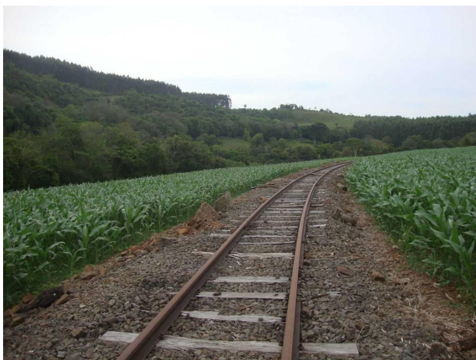
Figura 46 - Trilho de trem na margem esquerda do rio do Peixe, na AID da PCH.
