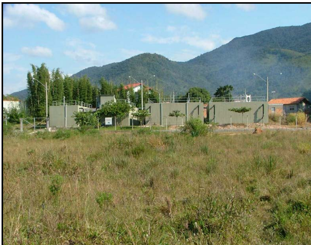
Figura 45. Estação de Tratamento de Efluentes (ETE) do loteamento Palmas do Arvoredo.
