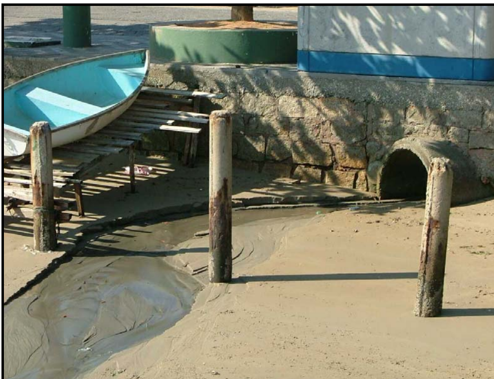
Figura 40. Ponto de lançamento água pluvial (e possivelmente de efluentes domésticos).
