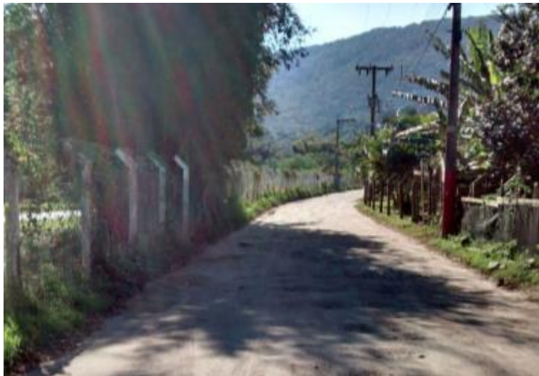
Figura 6-161 - A Servidão Amantino Cameu conecta residências de setores restritos do bairro à SC 406. Suas condições de trafegabilidade são precárias.
