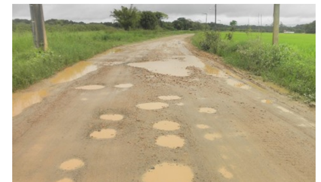
Condição da Estrada Poço Grande em período de chuvas.
